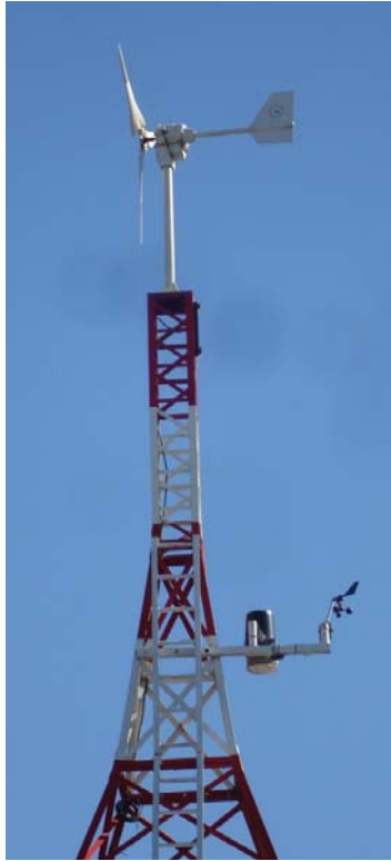
Figura 2. Generador eólico instalado en el sitio de pruebas
